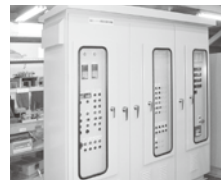
電気・計装盤
