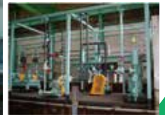
ポンプユニット W2200×L6000×H2500
