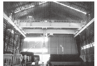
天井クレーン
